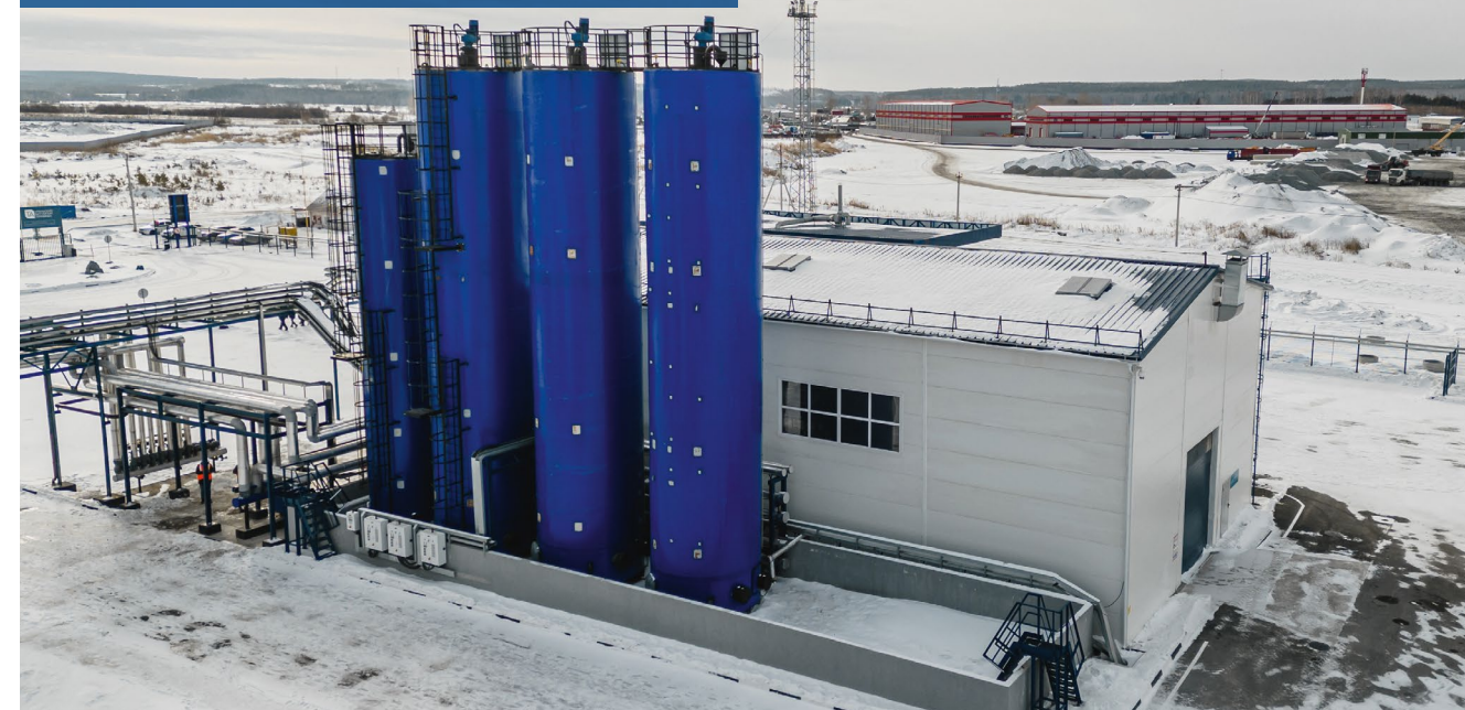
Битумный терминал, г. Екатеринбург. Резервуары мобильные интенсивного нагрева ErichHahn MT
